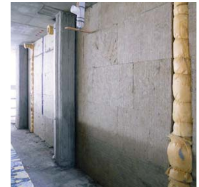
Pannello di lana di roccia tra le unità abitative
