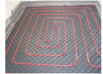
Pannelli radianti a pavimento
