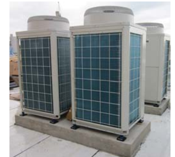
Macchine climatizzazione centralizzata in copertura
